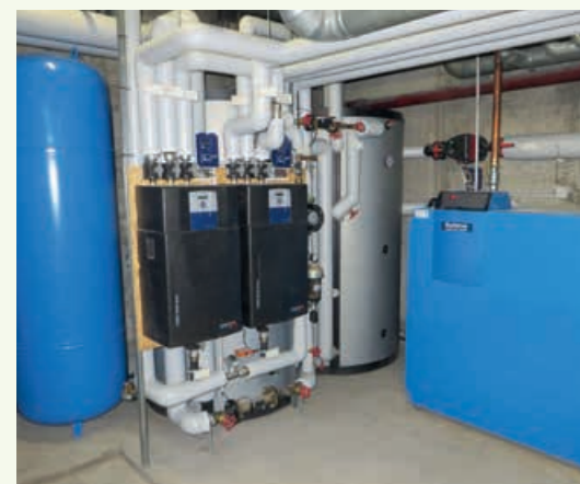
Trinkwasserversorgung, Speicher und Kessel
